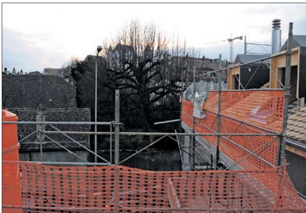
La réparation de la toiture peut être considérée comme des travaux de construction nécessaires.
